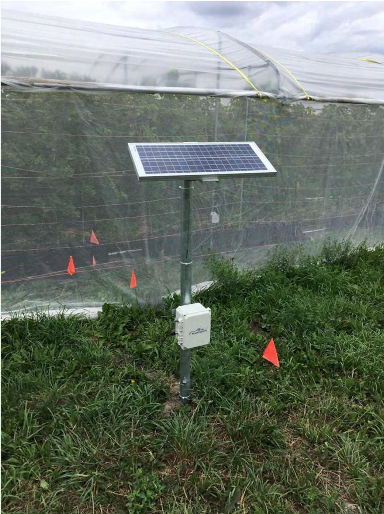
Figure 19. Module et panneau solaire (SimpliCollect), framboisiers en pots sous abri
