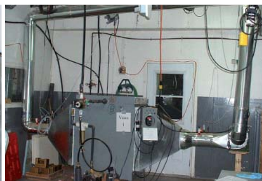
Unité de traitement de l'air
