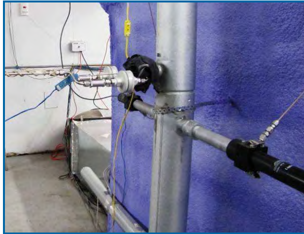
Figure 7. Sondes d'échantillonnage de gaz et opacimètre installés sur la cheminée
