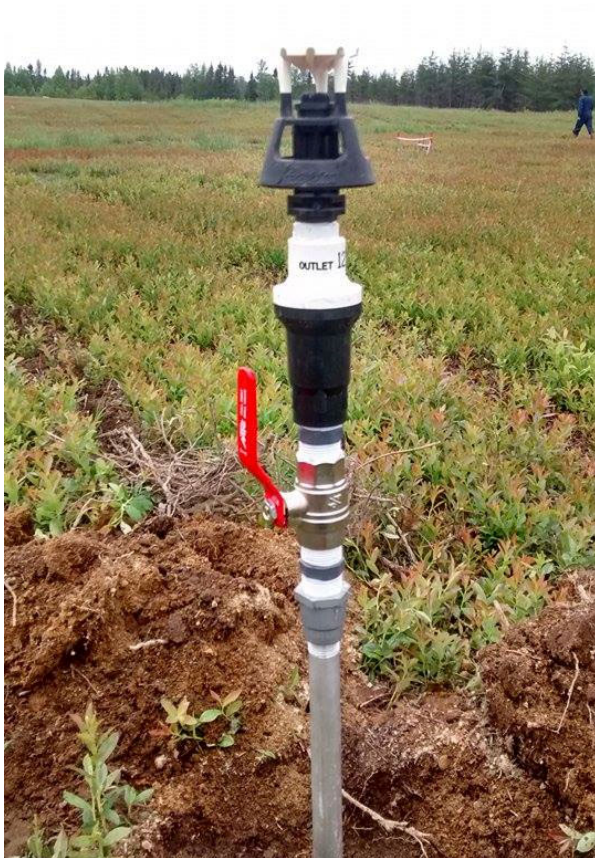
Figure 65 : Gicleur Xcel-Wobbler® avec un régulateur de pression (12 psi) et une valve – Saint-David-de-Falardeau.
