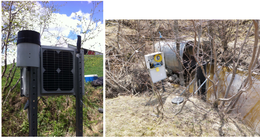
Figure 7. Dispositif d'alimentation solaire et d'enregistrement électronique des mesures provenant des sondes, installé sur la rive dans le bassin de la rivière Champlain Brûlée.
